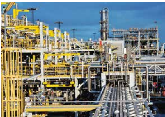
Prosessanlegget på Kollsnes mottar gass fra felt i havet, behandler gassen og sender den videre i rørledninger til det europeiske markedet. Nær 40 prosent av norsk gass går via anlegget på Kollsnes utenfor Bergen. Foto: Gassco, Øyvind Sætre
